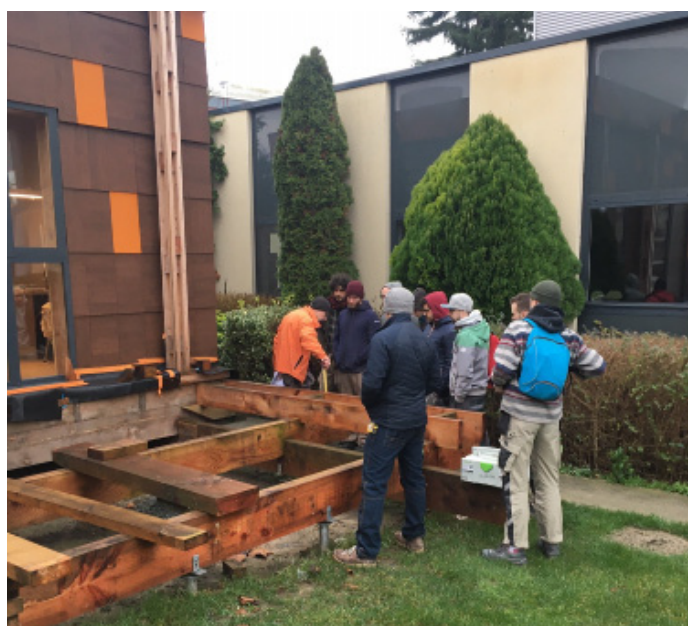
Vue sur les gîtes installés en 2017
