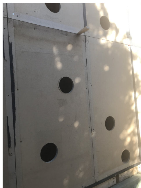
Montage des caissons BRIC2 Détails des faces extérieures des caissons de réemploi
