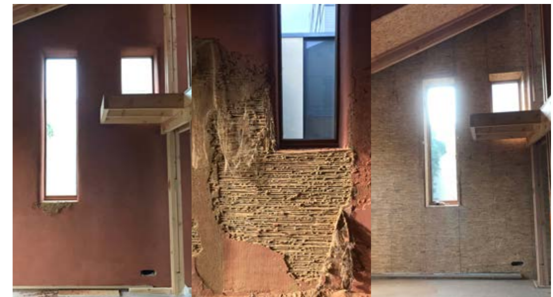
Figure 88 : Finition à l'argile sur une natte de roseaux vissée (Source : Caroline Morizur, efp)
