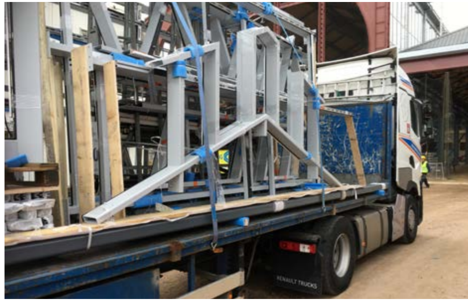
Figure 128 : Arrivée des sections de façade et des montants sur le chantier. (Source : Jansen AG)
