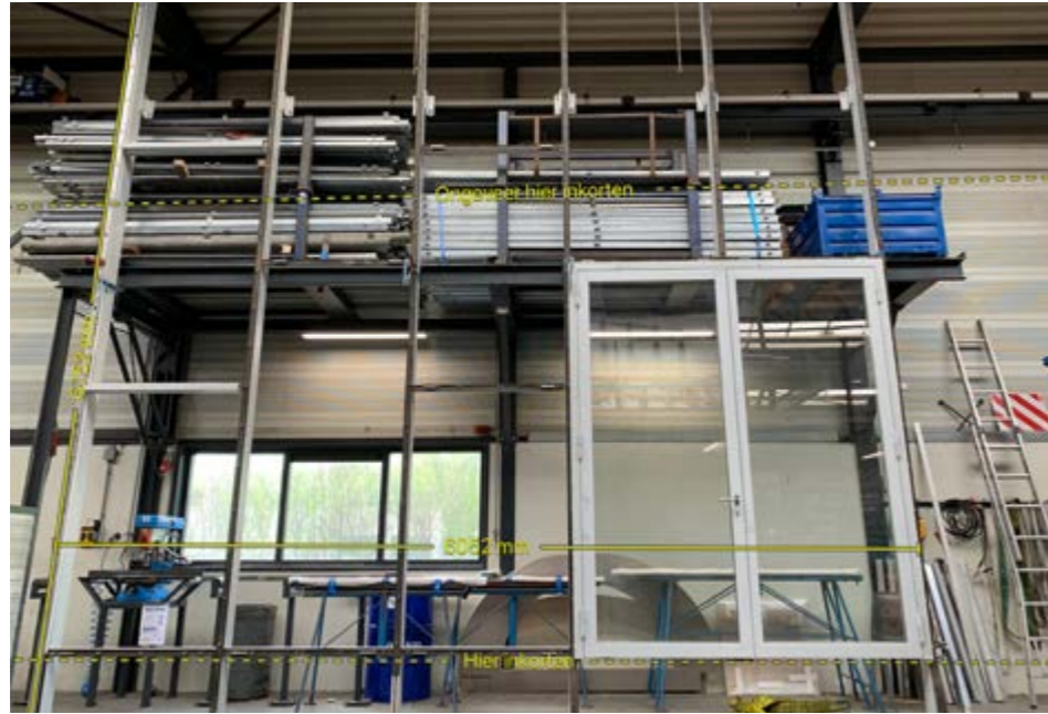
Figure 119 : Après mesurage du nouveau site, deuxième phase de reconfiguration en atelier. (Source : Blonkstaal)
