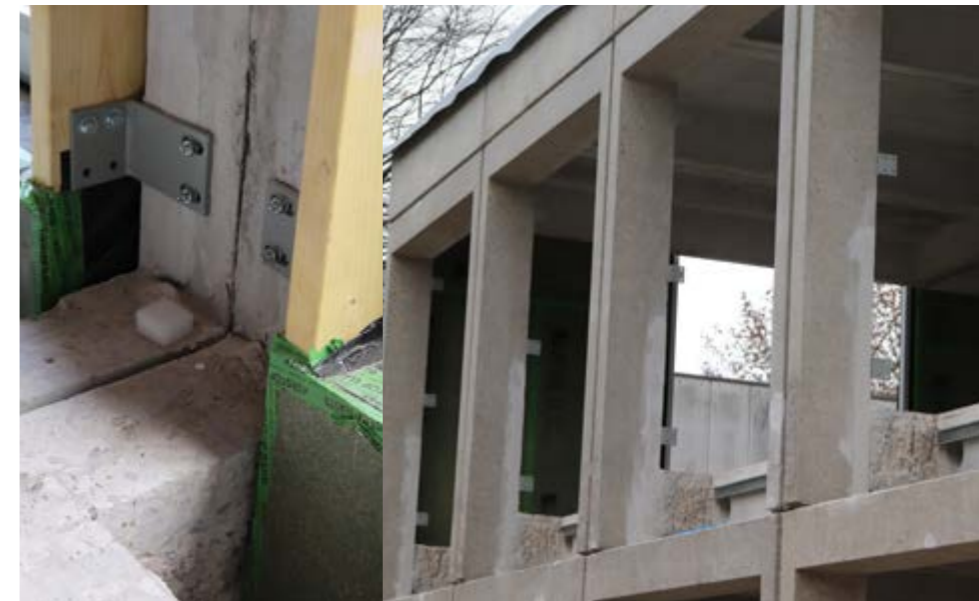
Figure 106: Les panneaux de façade sont connectés à la structure par le biais d'éléments de base indépendants (Source: Architectural Engineering, VUB)
